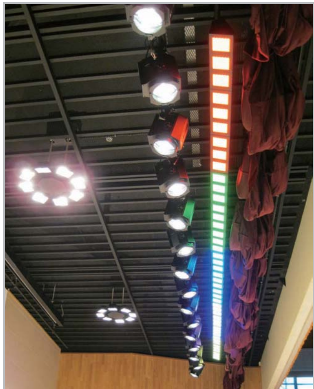
무대 조명 전체 전동 승하강 / 유지보수성
