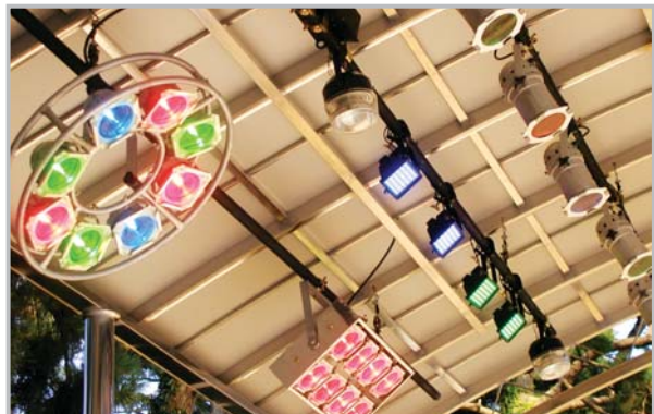
남해 학생수련원 옥외 무대 _ LED 조명 외
